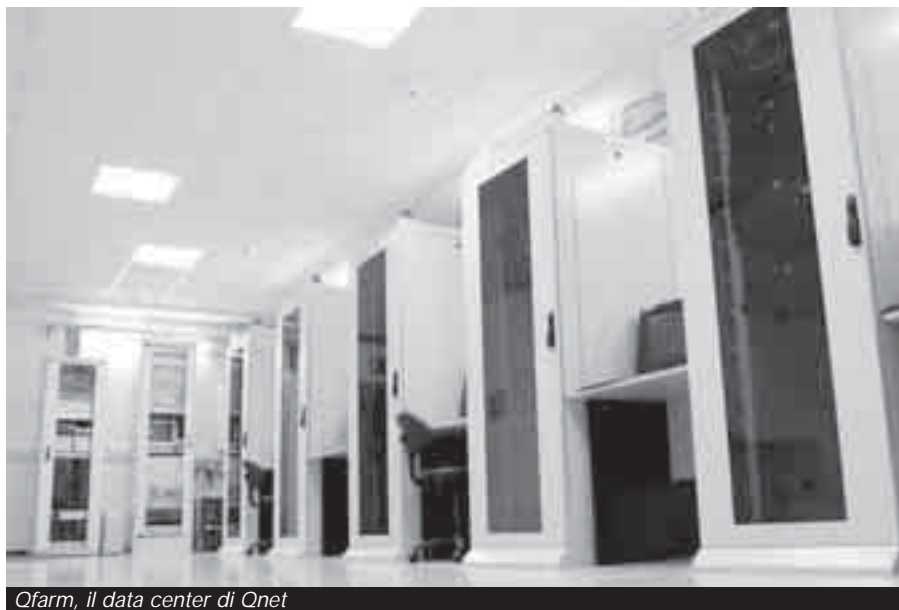
Qfarm, il data center di Qnet
